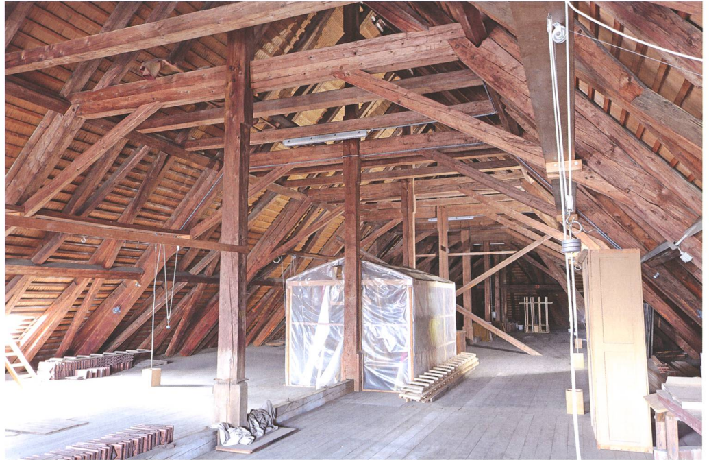
Abb. 8: Wollerau, Pfarrkirche St. Verena, Aufrichte Ende 1782, Baumeister Niklaus Purtschert, Übersicht über das Langhausdachwerk von Nordosten.
