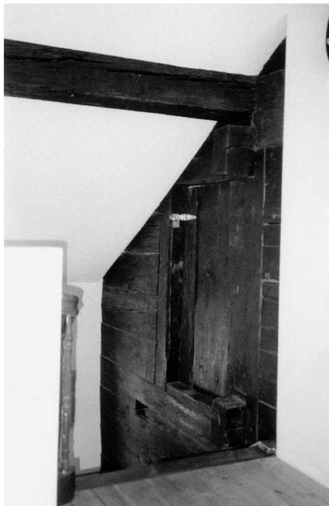
Abb. 14: Arth, Alte Post Oberarth. Im Dachgeschoss sind die Strukturen in spätmittelalterlicher Bautradition noch sichtbar.
