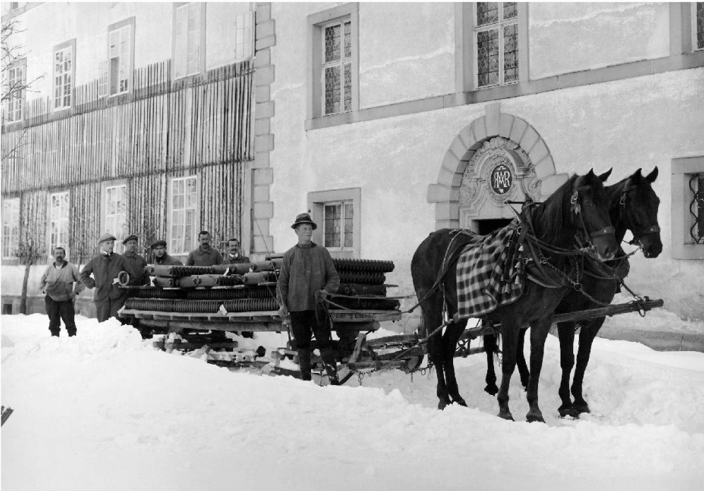
Abb. 29: Einbau der Zentralheizung 1925: Arbeiter mit den Radiatoren, welche in den Räumen des Klosters eingebaut wurden (Foto: Lienhardt, Einsiedeln).
