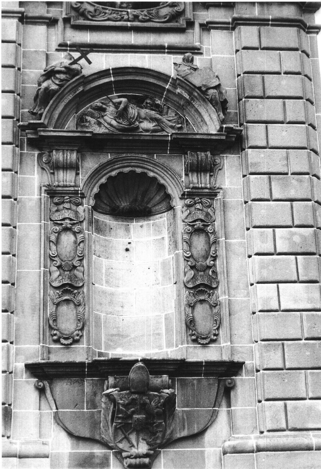
Abb. 20: Einsiedeln, Kloster, Nordfassade. Ausschnitt aus dem Risalit. Die Detailaufnahme zeigt die zurückhaltenden Ergänzungen beim Sandstein.
