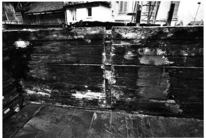
Abb. 39: Mittlere Trennwand des Hauses, Obergeschoss: Negativ der ehemaligen Blockwand zwischen den Räumen 2.9 und 2.10, Ansicht gegen Süden.
