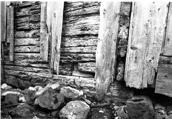
Abb. 23: Ostfassade, Detail: mit modernen Vierkanthölzern verschlossene Negative je eines Einzelvorstosses und von Deckenbohlen einer ehemaligen Nordostkammer im 1. Wohngeschoss.
