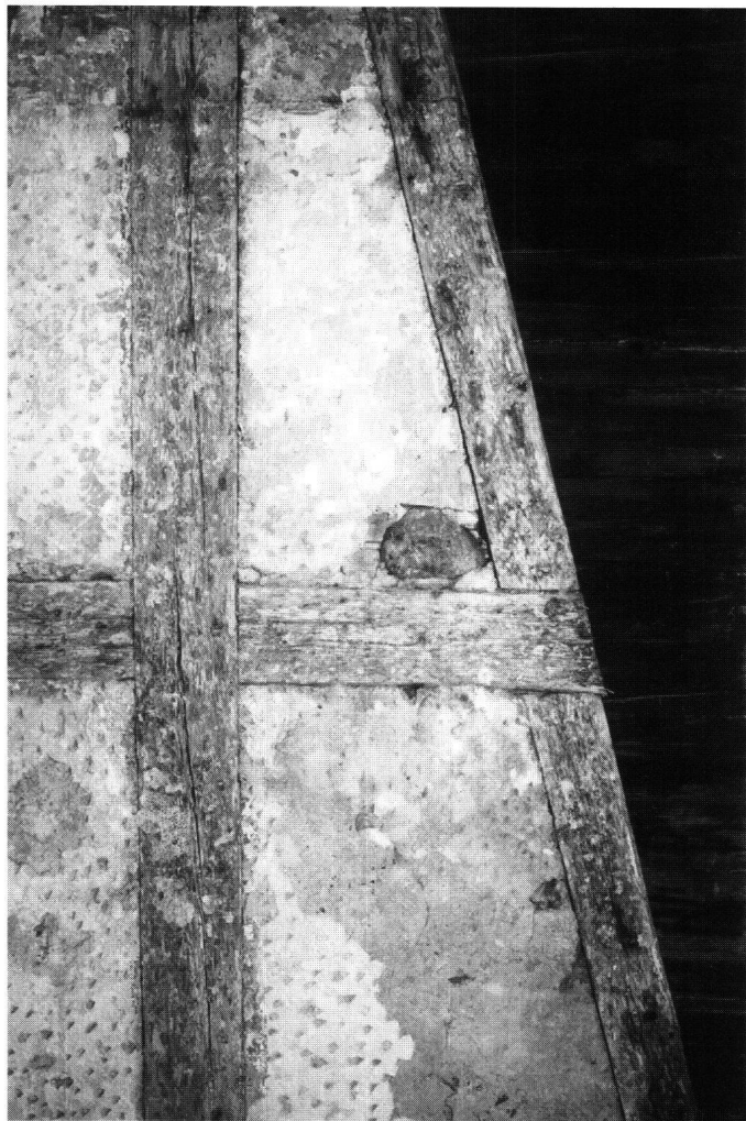
Abb. 16: Einsiedeln, Falken . Im zweiten Obergeschoss fand sich unter späteren Verputzschichten das ursprüngliche Fachwerk, das anhand der Graufassung und der dunklen Begleitlinien der Gefache auf Sicht gedacht gewesen sein muss.
