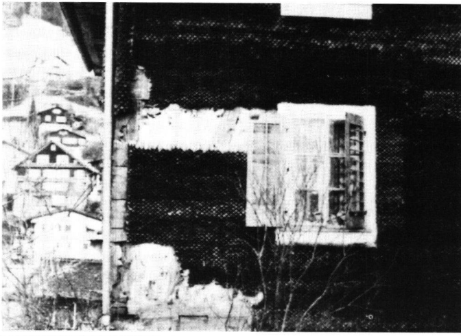
Abbildung 27 Morschach, Pfarrhaus. Ausschnitt von der Rückfront mit teilweise freigelegter Fachwerkkonstruktion unter dem jüngeren Schindelmantel.
