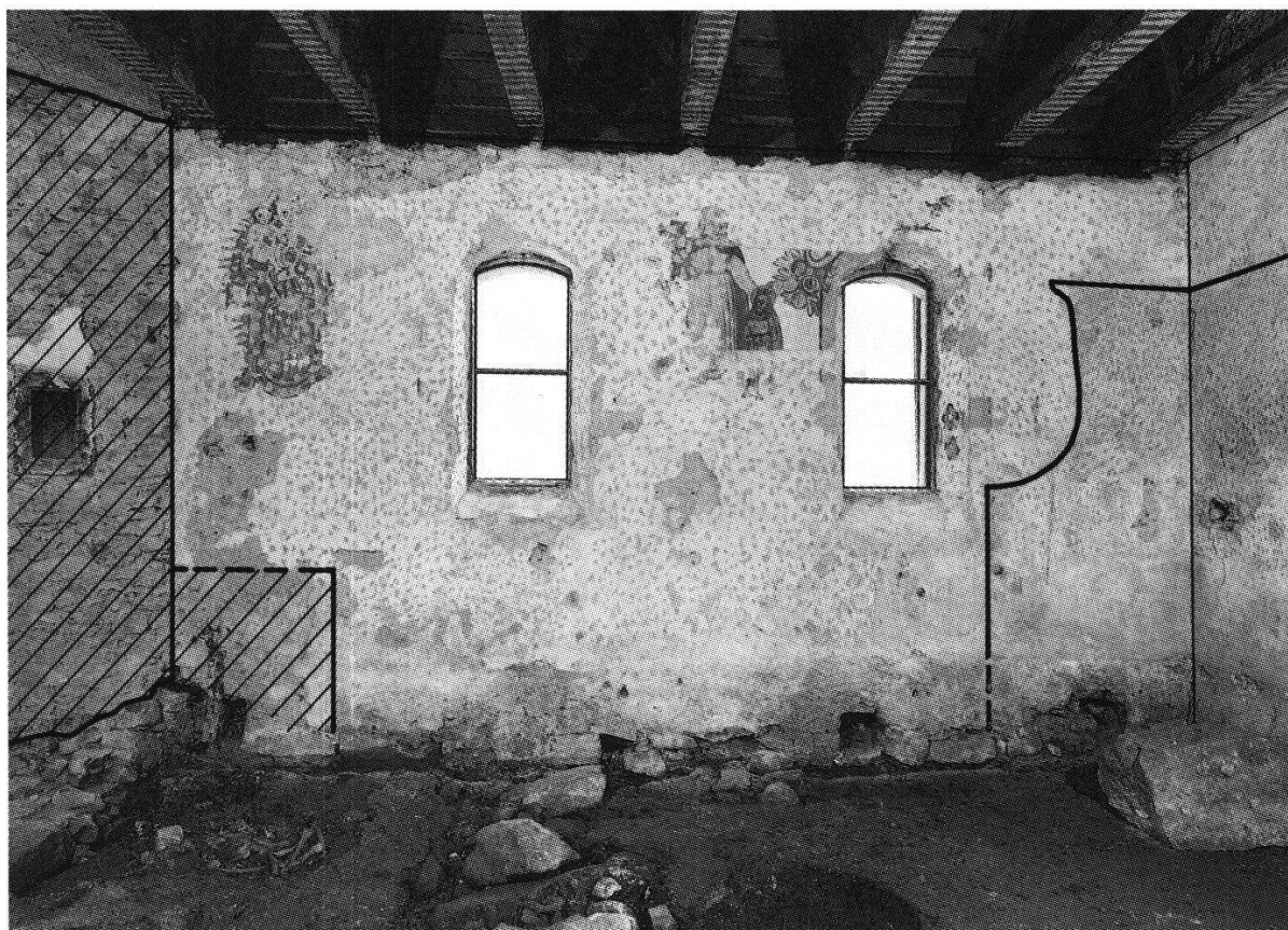
Abbildung 6 Südwand des Schiffes zur Zeit der archäologischen Untersuchungen. Links im Bild sind (schraffiert) der vermauerte Ausriß der südlichen Chorschulterwand und daran angrenzend die aufgrund von Verschmutzungen faßbare Form des ehemaligen Nebenaltars zu erkennen. Die Mauertlöcher im untern Teil der Wand sind 1828 zur Belüftung des Hohlraumes unter dem Fußboden angelegt worden (Foto Fibbi-Aeppli).
