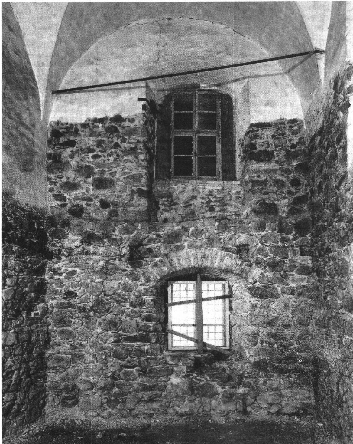
Abbildung 32 Nazareth, Ansicht der Nordwand. Die sichtbaren Balkenlöcher stammen vom Einzug einer Holzdecke im 19. Jahrhundert.
