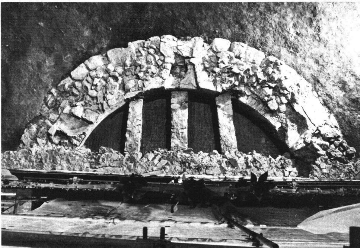
Abb. 18 Aufsicht vom Chorgitter auf den romanischen Kryptenschluß mit den Resten von drei Fenstern. Im Krypteninnern gemauerte Abt-Grüfte.
