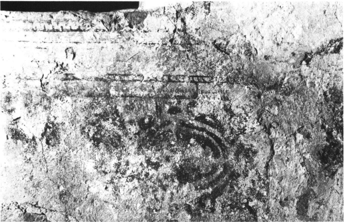
Abb. 19 Verputz an der Innenwand der romanischen Krypta: Graue Fassung um das mittlere Fenster, darunter rotes Damastmuster auf gelbem Grund (zweite Hälfte 15./erste Hälfte 16. Jh.).
