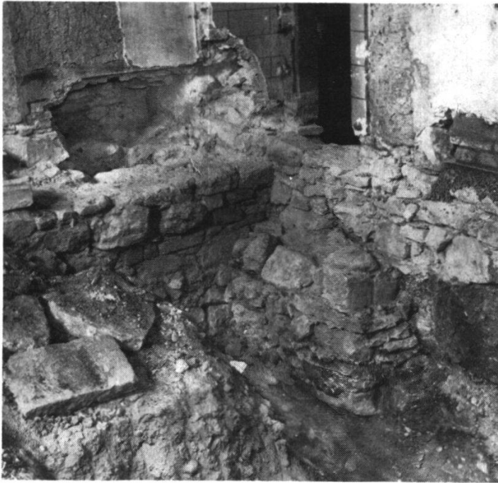
Abb. 57 Südecke des Inneren Chores. Triumphbogen-Fundament und Ansatz der Seitenmauer des Chörleins von 1616. Die Türe führt ins Altarhaus.
