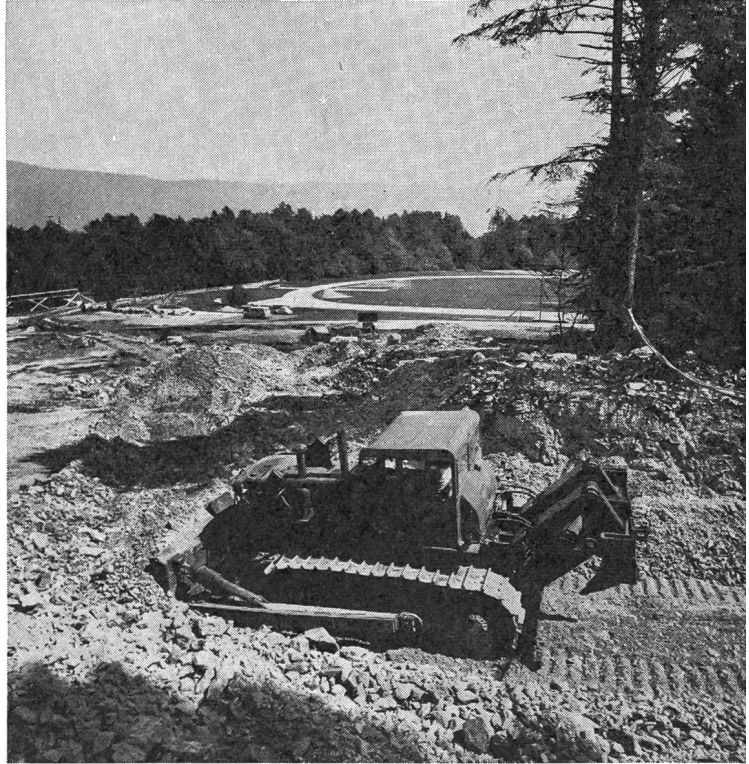
Les fouilles en mai 1974. Le chantier était encore un amas de décombres.
