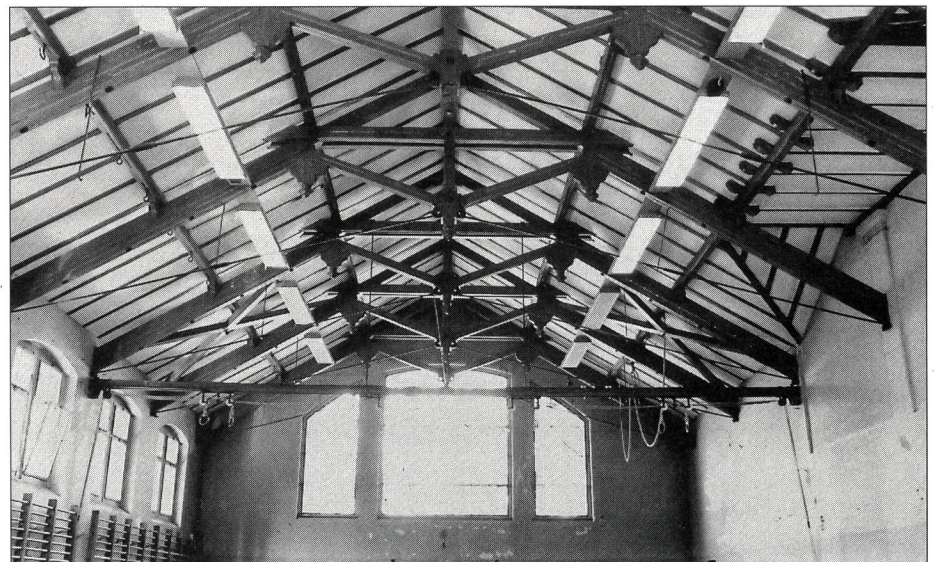
Turnhalle Spitalacker, Bern: Sehenswerte Dachkonstruktion. Fläche zur Verbesserung der Akustik mit schallabsorbierenden Platten.
