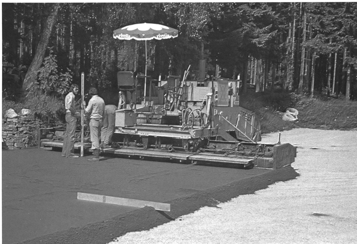
Hochmechanisierter Sportrasenbau – Mit einem Strasseneinbaufertiger wird das, ausserhalb des Spielfeldes mit Spezialmaschinen aufbereitete Rasentragschichtgemisch über dem wasserdurch-
