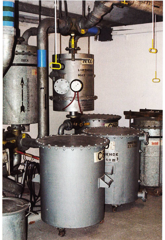
Abb. 62 Die Luftfilteranlage für das gesamte Werk ist bei der Kaverne. Vorne auf Rollen die eigentlichen Filter.
