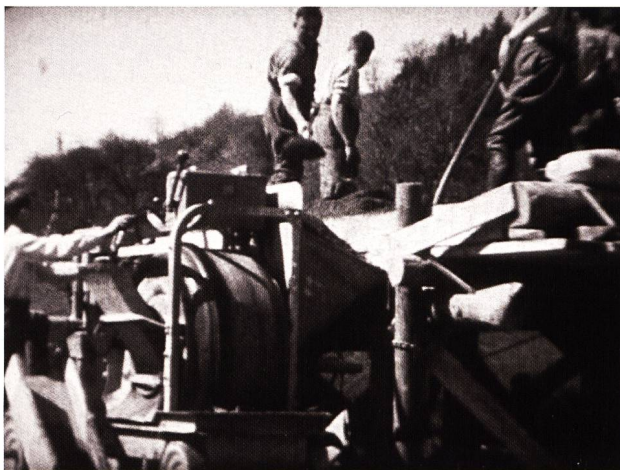
Abb. 33 Ein baugleicher Betonmischer kam auf der Baustelle für das Werk Grynau zum Einsatz. 19
