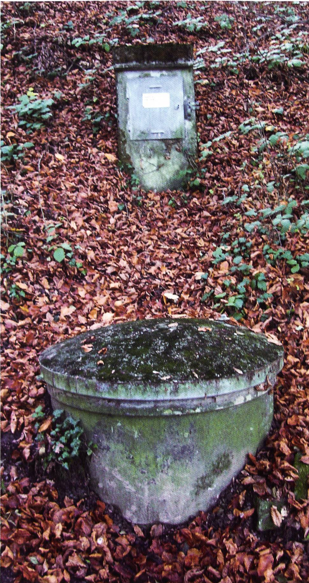
Abb. 24 Der Notausstieg mit Deckel offen, im Hintergrund befindet sich ein Feldanschlusskasten für Telefon.
