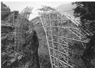
Richard Coray: cintre du pont de Gmündertobel (Appenzell). Tiré de Gerüst- und Seilriesenbauer Richard Coray von Trins, op. cit.
