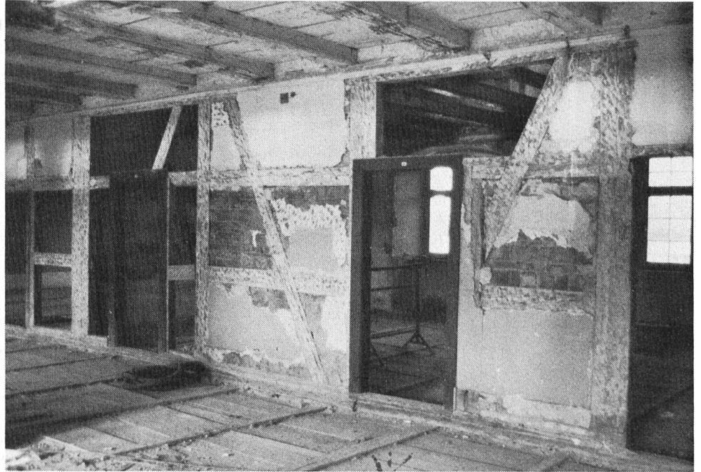
Konventstock, gestörte Riegelkonstruktion.
