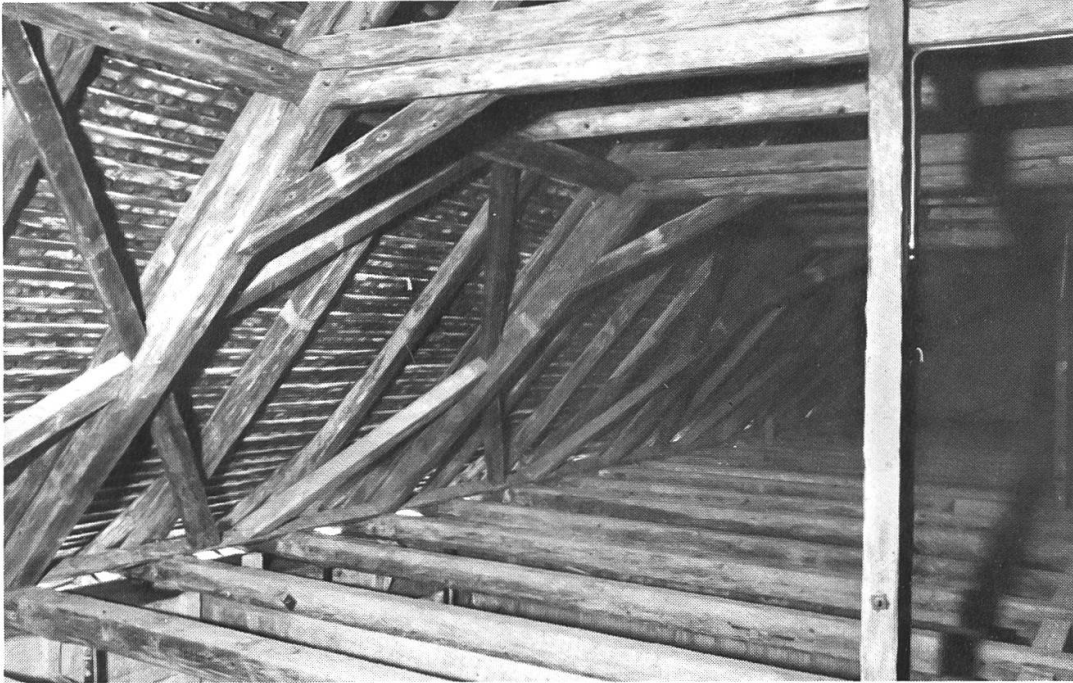
Dachstuhl. Die etwa 150jährige Konstruktion ist noch äusserst solide und bis auf einige Sparren, die ersetzt werden mussten, kerngesund.
