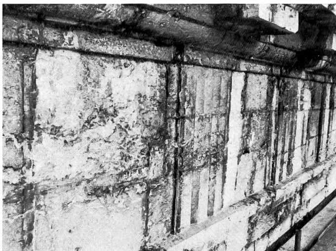
5 Metopen-Triglyphenfries, gegen Norden, Detail. Erfrorene Steinoberfläche. Die Schäden sind 3 — 5 cm tief.
