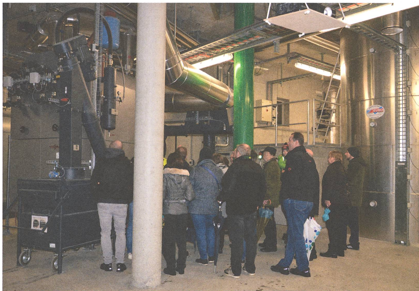
Tag der offenen Tür in die Fernwärme-Heizzentrale «Widmi» zvg
