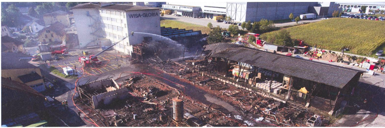
Die Luftaufnahme einer Drohne gibt einen Überblick auf die verheerenden Brandschäden. Foto CI
