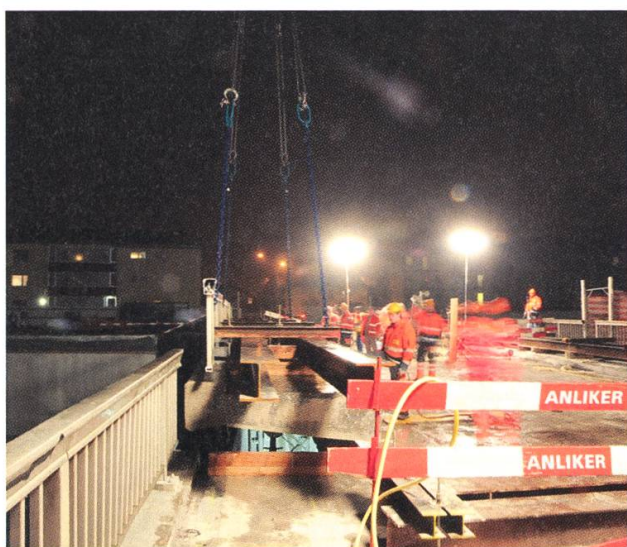
Das erste tonnenschwere Stück der Hardbrücke wird heraus gehoben und abtransportiert. Foto TW
