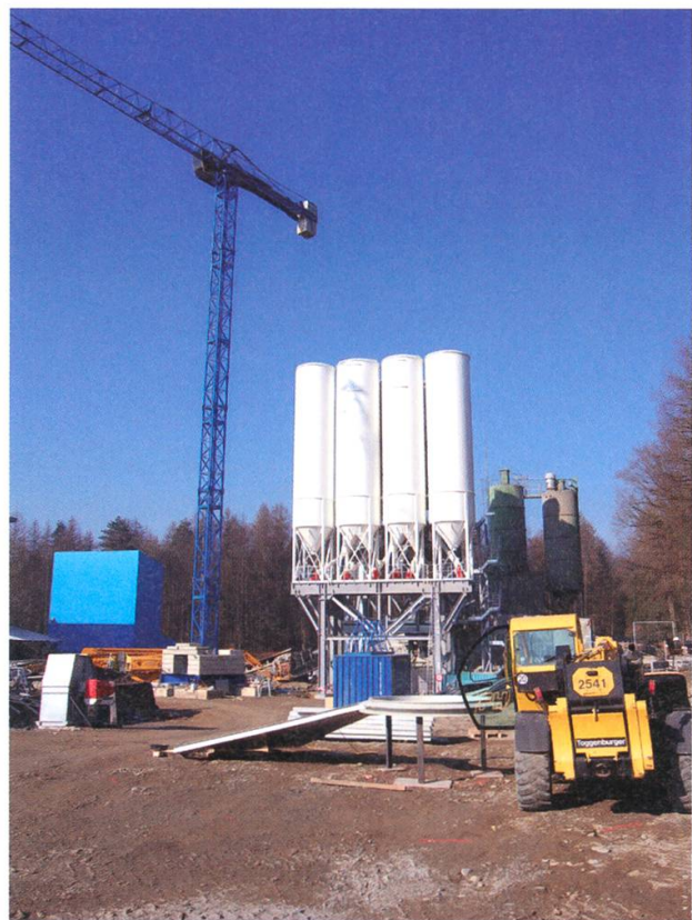
Die neue Betonmischanlage im Kiesabbaugelände Lenzhard wird künftig gut ausgelastet.
