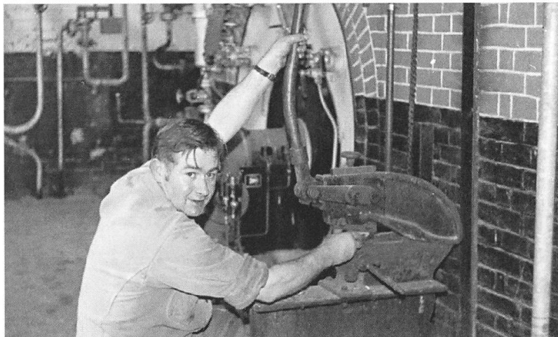
Die Dampfkesselanlage stammte aus dem 19. Jahrhundert. Die Werkstatt war in diesem Gebäudeteil untergebracht und wurde von Hugo Schild betreut.
