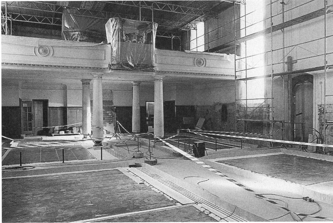
Blick ins Kirchenschiff während der Bauzeit. Zu beachten ist die fertig montierte Platten-Bodenheizung. (Fotos: Hans Weber).
