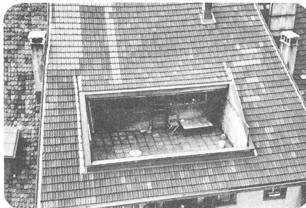
Abb. 101, Gegen die Regel verstossender neuerer Dacheinschnitt (Brättligäu)
