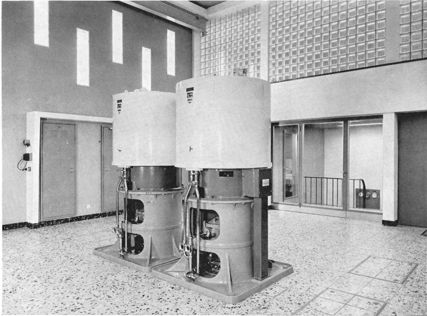
Motorenraum des Pumpwerkes, ausgerüstet mit zwei luftwassergekühlten Elektromotoren Brown, Boveri von 425 PS Leistung
