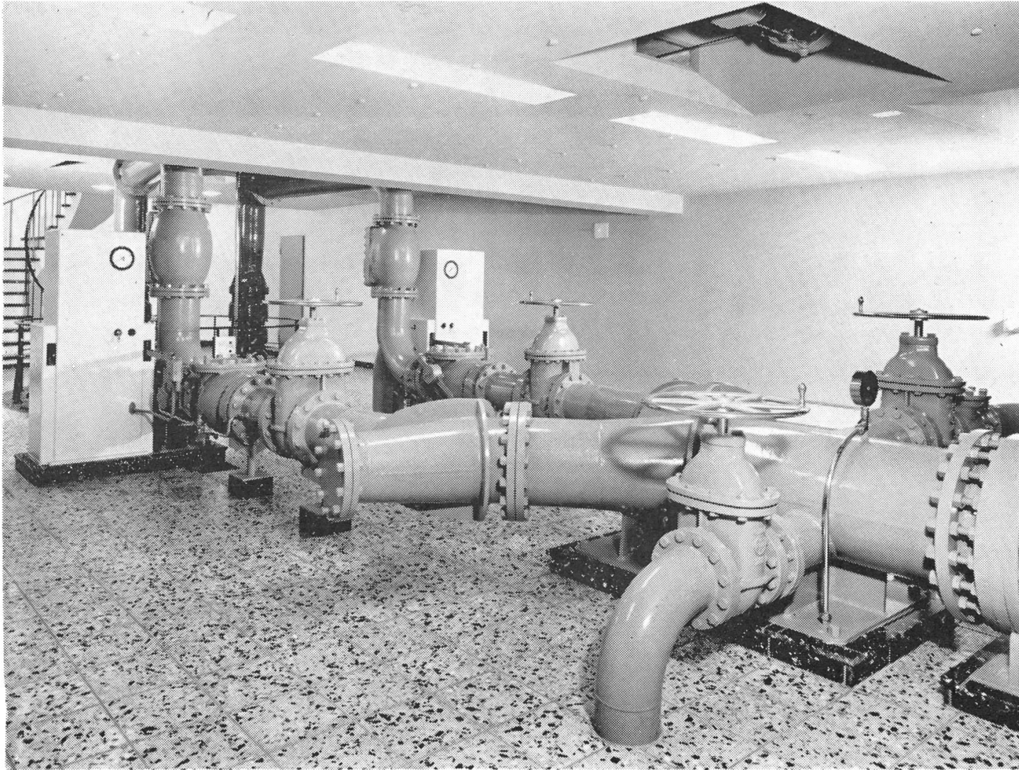
Rohrkeller des Pumpwerkes Klappen, Schieber und hydraulische Steuerapparate
