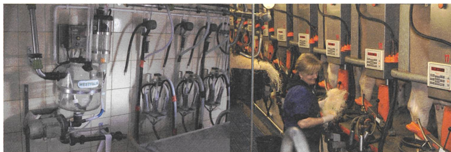
Grosse Unterschiede in der Milcherzeugung – Rohrmelkanlage mit drei Melkgeschirren bei Familie Antolak (21 Milchkühe) und Doppelwölfer-Fischgrät-Melkstand auf Juchowo (360 Milchkühe)
