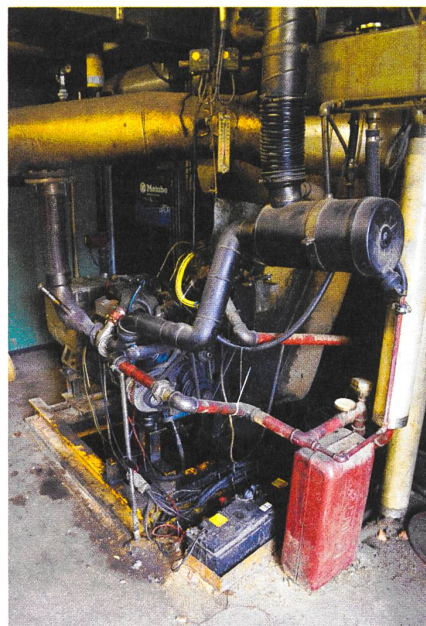
Das Blockheizkraftwerk produziert Strom und Wärme aus altem Frittieröl. Foto: Markus Schär
