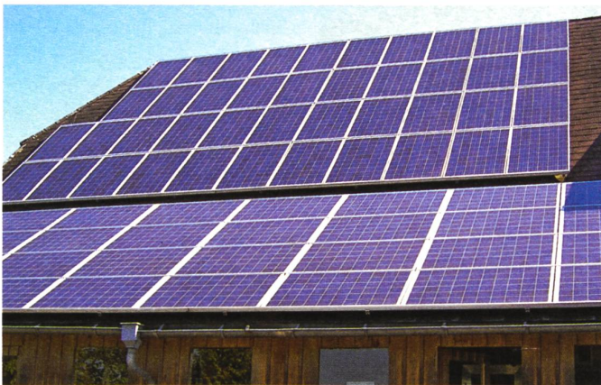
Ernst Iseli in Wyssbach nutzt die Dächer seines alten Bauernhauses und der neuen Scheune zur Stromgewinnung
