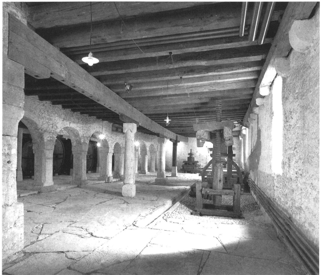
4 La Neuveville, Cour de Berne (Maison de Bellelay), Weinkeller, 1630er Jahre. – Raumeindruck der Westhälfte. Tragmauer mit Arkadenfolge, Unterzug teilweise auf wiederverwendeten Stützen des 15./16. Jh. Statische Sanierung durch die Stadt Bern 1985/1986.
