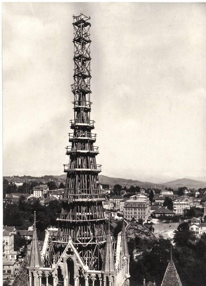
Lausanne, Kathedrale , Gerüst für die Restaurierung und Umdeckung des Vierungsturms. Foto André Kern, 1927
