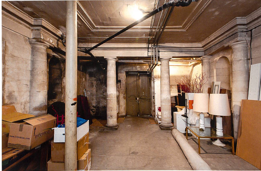
Fig. 6 Le nymphée de l'hôtel Besenval, état actuel, vue sud. © Bundesamt für Bauten und Logistik / Renaud Sterchi
