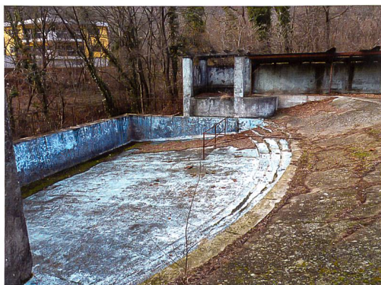
La piscina di Arzo in stato di abbandono come si presenta oggi. Fotografia Simona Martinoli
