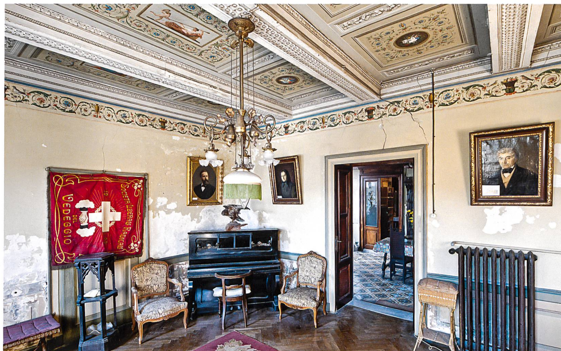
Torricella, la «Sala dei ritratti». Si nota il soffitto in stile neoclassico riccamente decorato. Sulle pareti si vede il deterioramento delle stesse a causa dell'umidità. (Foto Michael Peuckert)
