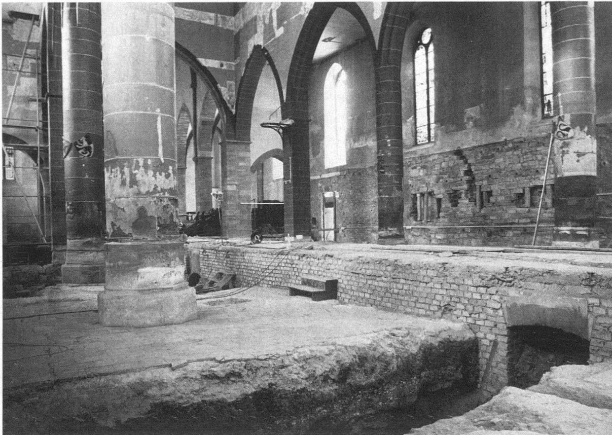
Basel, Predigerkirche. Bei der Innenrestaurierung und Grabungen kam ein unteres Bodenniveau zum Vorschein
