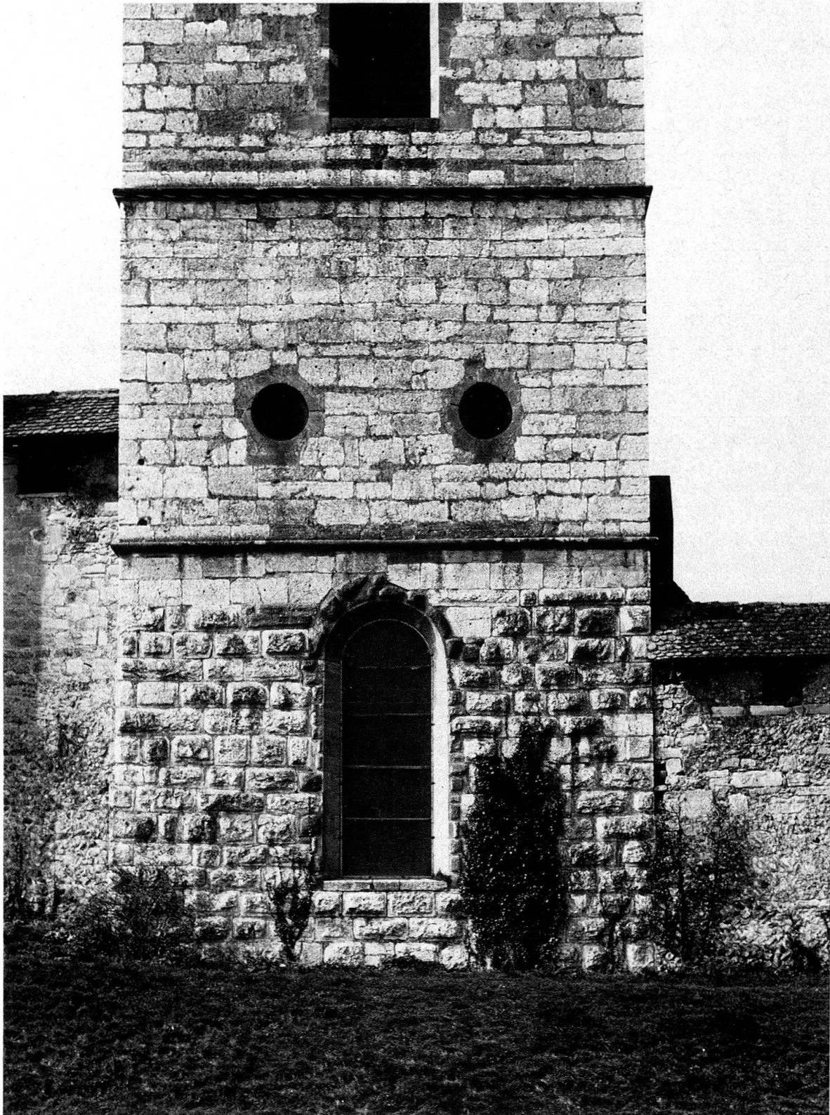
Abb. 1. Turmsockel der Deutschen Kirche von Osten. Vermutungsweise wird die Frage gestellt, ob die untersten 15 sichtbaren Steinlagen nicht ursprünglich zu einem Wehrturm aus dem 12. Jahrhundert gehören. Die Aufnahme zeigt, dass die seitlich anstossende Stadtmauer, wohl aus den dreissiger Jahren des 13. Jahrhunderts, nachträglich an den Turm angefügt und das Rundfenster später in die Wand eingebrochen worden ist.
