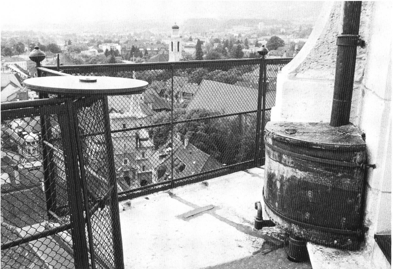
1 Die Aufstellung der Orientierungstafel in der SW-Ecke der Turmgalerie. Rechts, an den Turm angelehnt, sehen wir den kupfernen Regenwassersammler. Er ist von 1771 datiert. Die Kirche wurde in den Jahren 1763–1773 erbaut.
