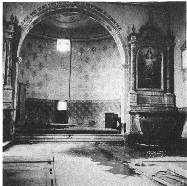
Das Innere im November 1972. Die Farbe blättert, der Gips bröckelt, die Altarpodeste faulen im stehenden Wasser. (Foto Kantonale Denkmalpflege Solothurn).
