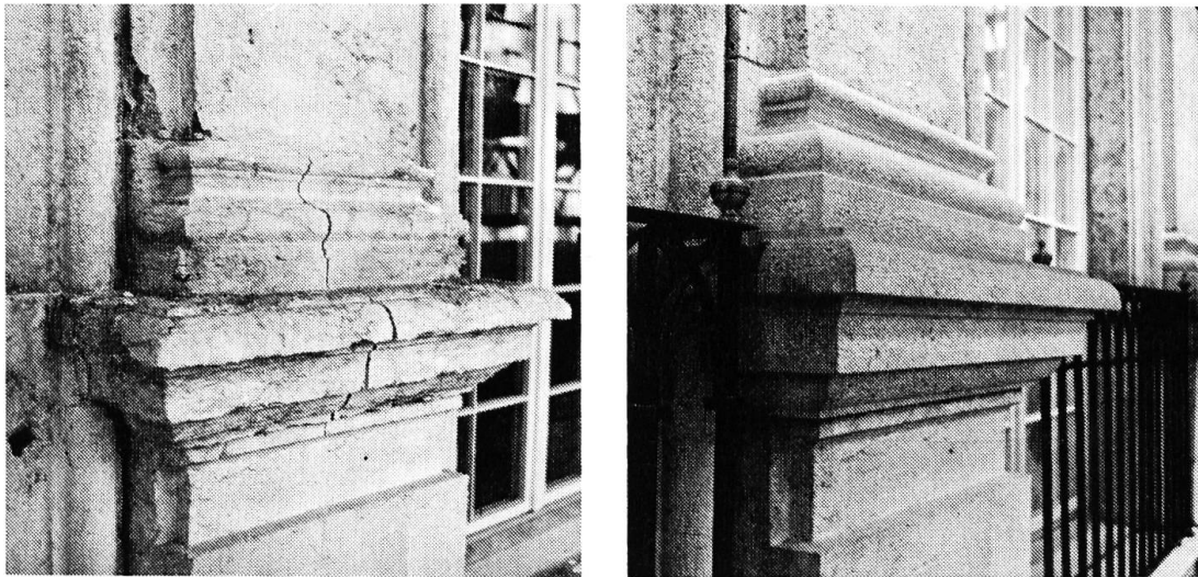
Pfeilerbasis im 1. Stock und Gesimse, vor und nach der Restaurierung (Foto: Architekturbüro Stampfli)
