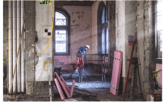
Kurz nach der Eröffnung des Erweiterungsbaus gingen die Sanierungsarbeiten mit dem Ausbau der historischen Zimmer im Westflügel weiter.
