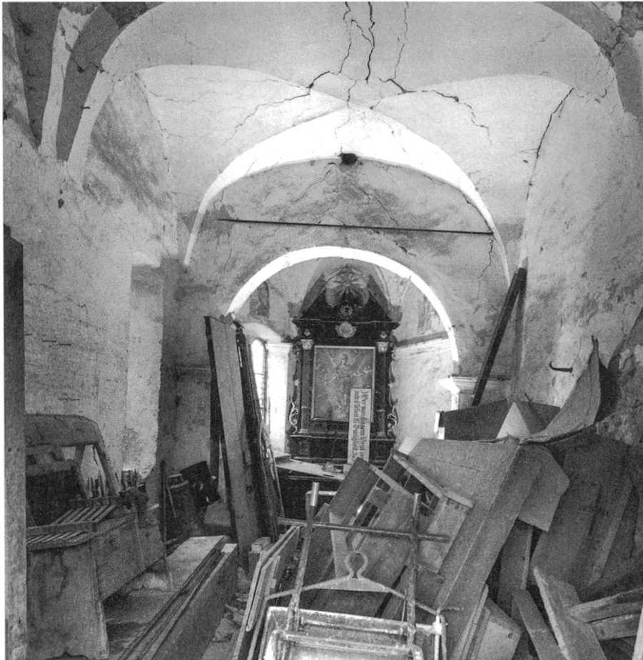
Abb. 22: Blick in die Michaelskapelle vor der Restaurierung 1967–1971 (Foto: Ernst Räss, Solothurn, Archiv Kantonale Denkmalpflege Solothurn).
