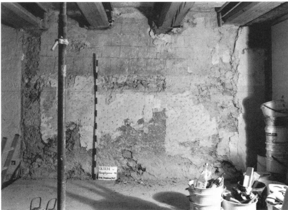
Abb. 4: Brandmauer West, 1. Obergeschoss, Partie Nord. Erkennbar ist in der oberen Wandhälfte die Quadermalerei zur spätgotischen Wandmalerei, darunter (über der horizontalen Messschnur) ein Boden negativ.
