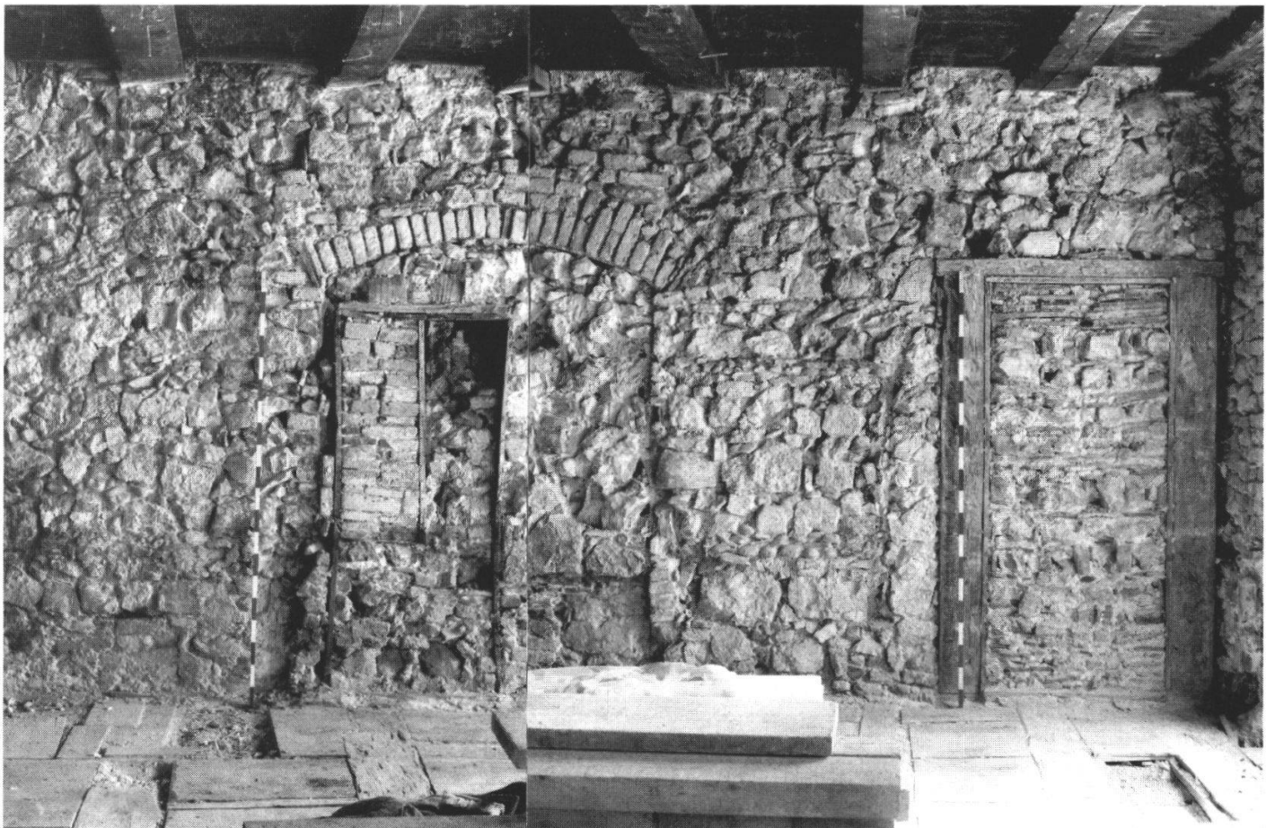
Abb. 12: Brandmauer Ost, Bereich Stube 1. Obergeschoss. Sekundär ins Mauerwerk eingesetzte und später wieder zugemauerte Türöffnungen zum östlichen Nachbarhaus. Sie stammen aus den Zeitspannen von 1634–1642 und 1672–1706, als die beiden Häuser Hauptgasse Nr. 9 und Nr. 11 dem gleichen Besitzer gehörten.
