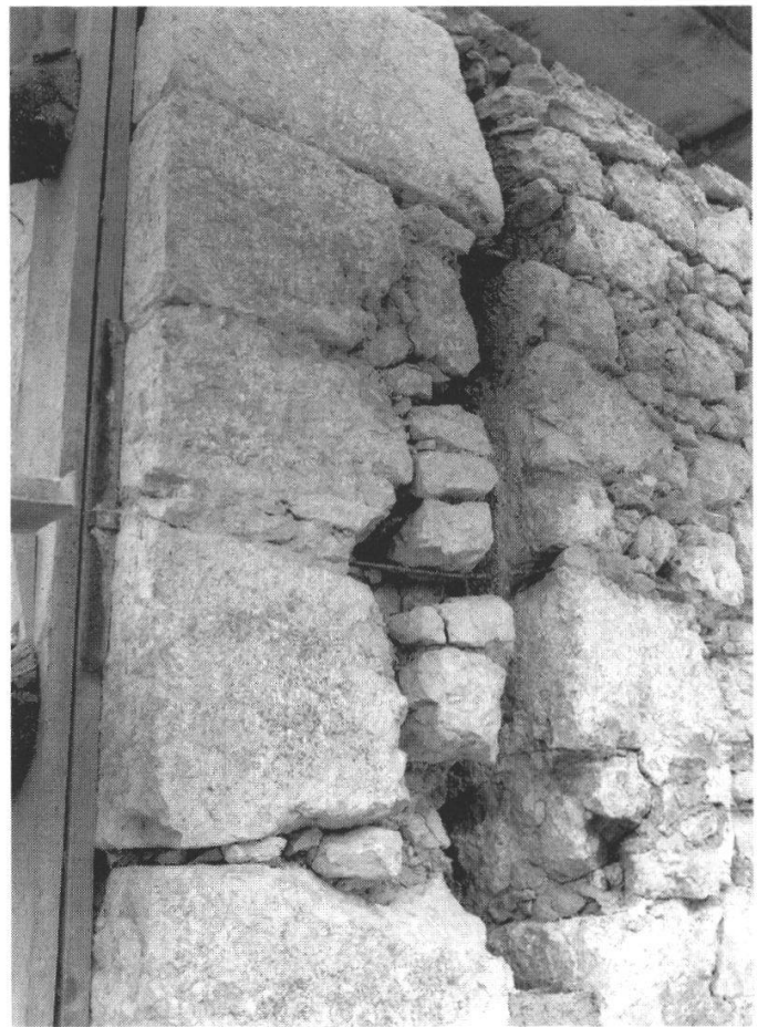
Abb. 7: Nach dem Entfernen des Verputzes zeigen sich im Bereich der Südostecke zwei Gebäudeecken, die ungenügend miteinander im Verband stehen. Links die Südostecke zur heutigen Fassade von 1614, rechts die ältere Südostecke eines Vorgängerbaus aus dem 16. Jahrhundert.
