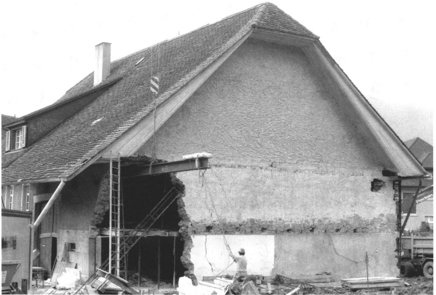
Abb. 4: Wenn einem alten Haus zuviel zugemutet wird: Einsturz einer Hausecke während des Umbaus. Aufnahme vom 28. August 1987.
