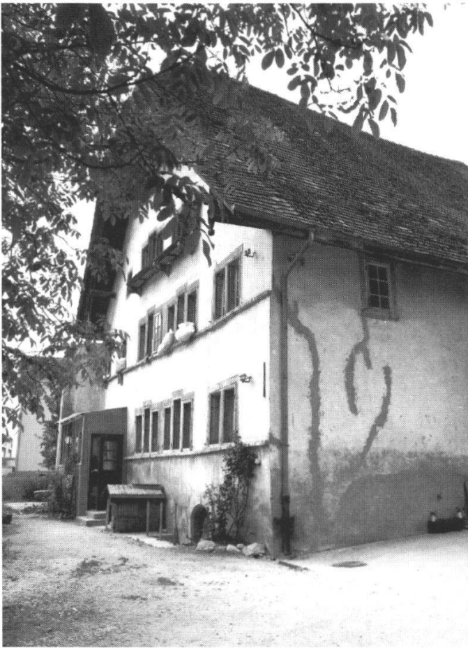
Abb. 6: Die Mühle vor der Restaurierung, von Südosten. Im Vordergrund zeichnen sich markante Setzrisse ab.
