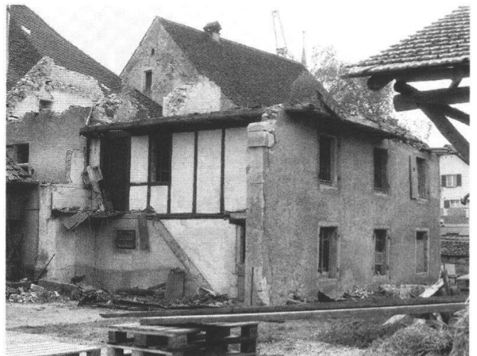
Abb. 5: Das «Gerichtsstöckli» von Nordosten, nach dem illegalen Abbruchbeginn, Mai 1987.
