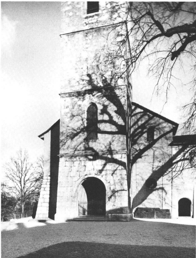
Abb. 1: Der Turm vor der Restaurierung von 1958 mit sehr stark abgewittertem Verputz.
