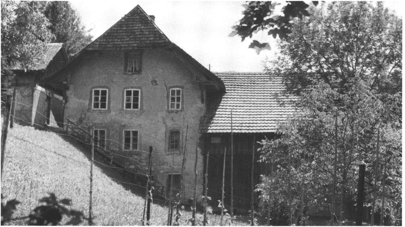
Abb. 1: Das Haus Säliloch in stark baufälligem Zustand 1986.
